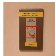
※ 非常放送のボリューム
